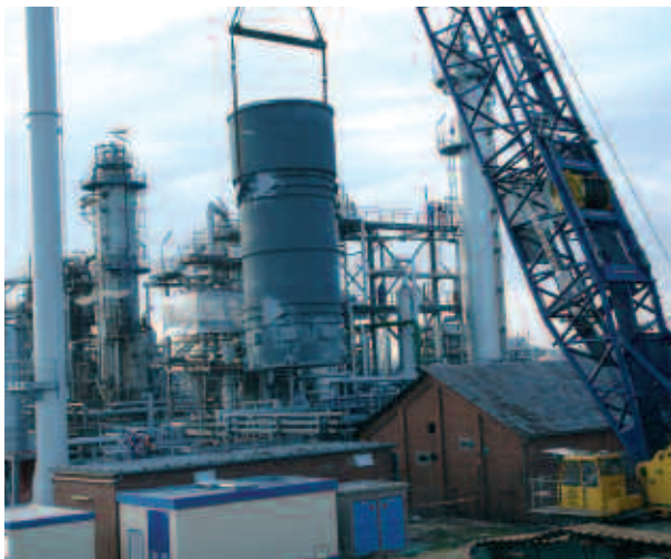
Neuer Erdgas-Ofen zur Erzeugung von Prozesswärme (H&R Ölwerke Schindler GmbH)
